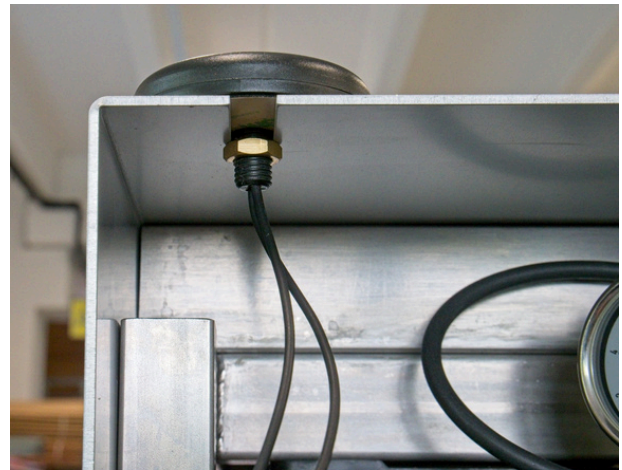
Antena montada en su zócalo
